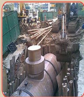
ถังเก็บน้ำมันเชื้อเพลิงใต้ดิน
